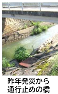
昨年発災から通行止めの橋
