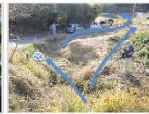
② 豪雨が用水路暗渠で閉塞し排水不能となり田圃～道路に水が溢れ流下した
