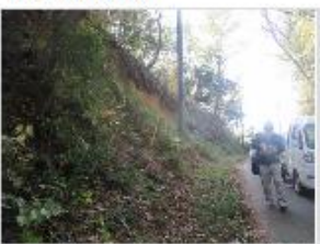
⑭ 通学路の切土のり面崩落
