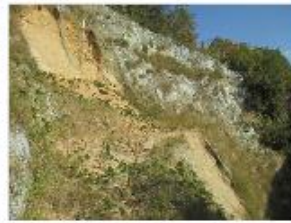
④ 住宅裏が崩落し避難した (2018年7月6日19時頃)
