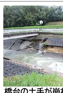
橋台の土手が崩れ通行止めに
