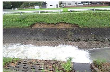
長雨で土手と擁壁との間に穴が開く。右側の川底は改修済
