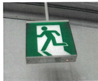
【誘導灯 (大ホール)】
