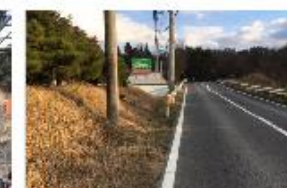
㉙道路陥没
