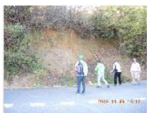
⑲斜面崩壊
