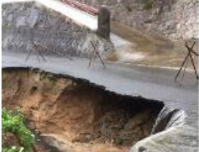
⑳道路の崩壊
