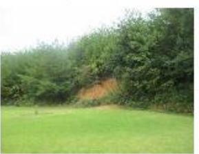
㉒斜面崩壊
