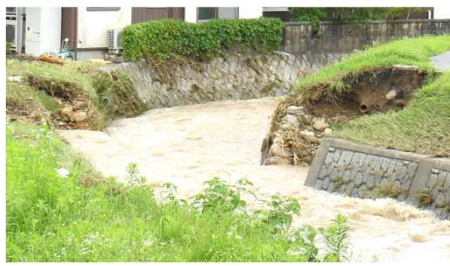
【河川擁壁の崩落:7/7撮影】
