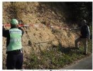
④のり面が崩落した
