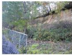
⑮のり面崩落の危険性あり
