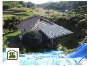
⑦中筋集会所 (屋根一部破損)
