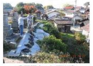
⑪西福寺のり面崩壊
