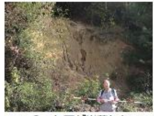
⑤のり面が崩落した
