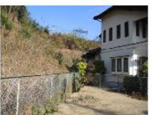
⑮のり面崩落の危険性あり
