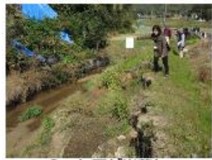
③のり面が崩落し 川に流れ込んだ
