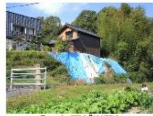
①のり面が崩落し 畑に流れ込んだ
