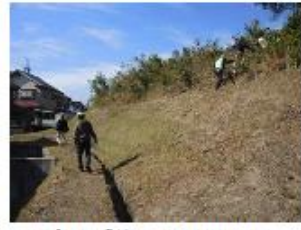
⑭水路が狭く溢れやすい。のり面崩落の危険性あり
