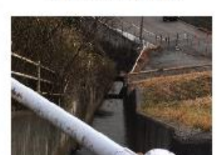
⑯階段になっており水がそのまま流れる
