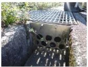
⑮側溝が詰まり溢れた
