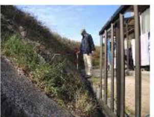
⑯太陽光パネルが建設され 排水が懸念
