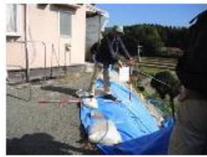
⑥崩れたのり面
