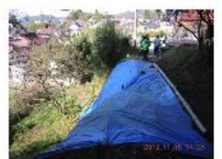
⑫光政寺斜面崩壊
