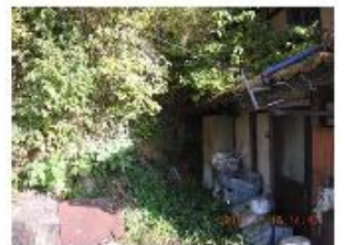
⑬この間から水が流出した
