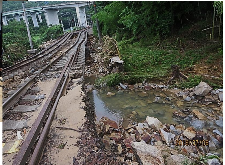
▼災害にあった線路（則重地区）
