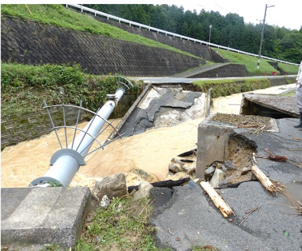
八本松西6丁目 全ての橋(3カ所)が破壊 7世帯が孤立状態
